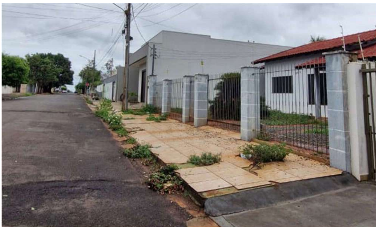
Foto 49: Calçada com piso irregular escorregadio e com mato, além do degrau prejudicando acessibilidade, situação encontrada em vários pontos da cidade (autor – 2024).
