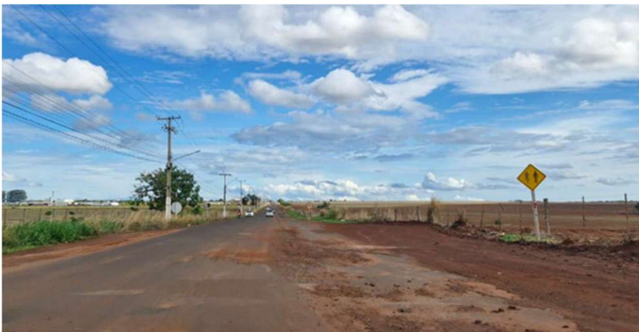
Foto 80: Situação precária da ciclofaixa existente no acesso ao bairro Jardim Alto da Boa Vista (autor – 2024).
