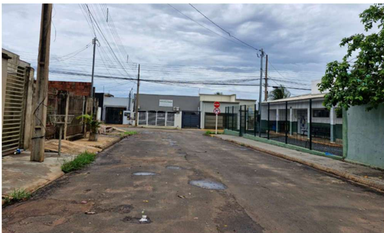
Foto 70: Pavimento com irregularidades de superfície, situação encontrada em diversas vias da cidade (autor – 2024).
