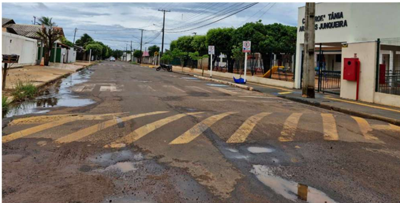
Foto 75: Ausência de escoamento de águas superficiais, situação encontrada em diversos locais da cidade (autor – 2024).
