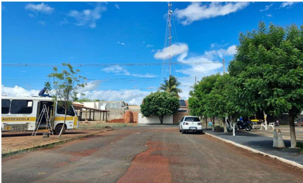
Foto 73: Pavimento “casquinha” com espessura insuficiente para o tráfego viário (autor – 2024).
