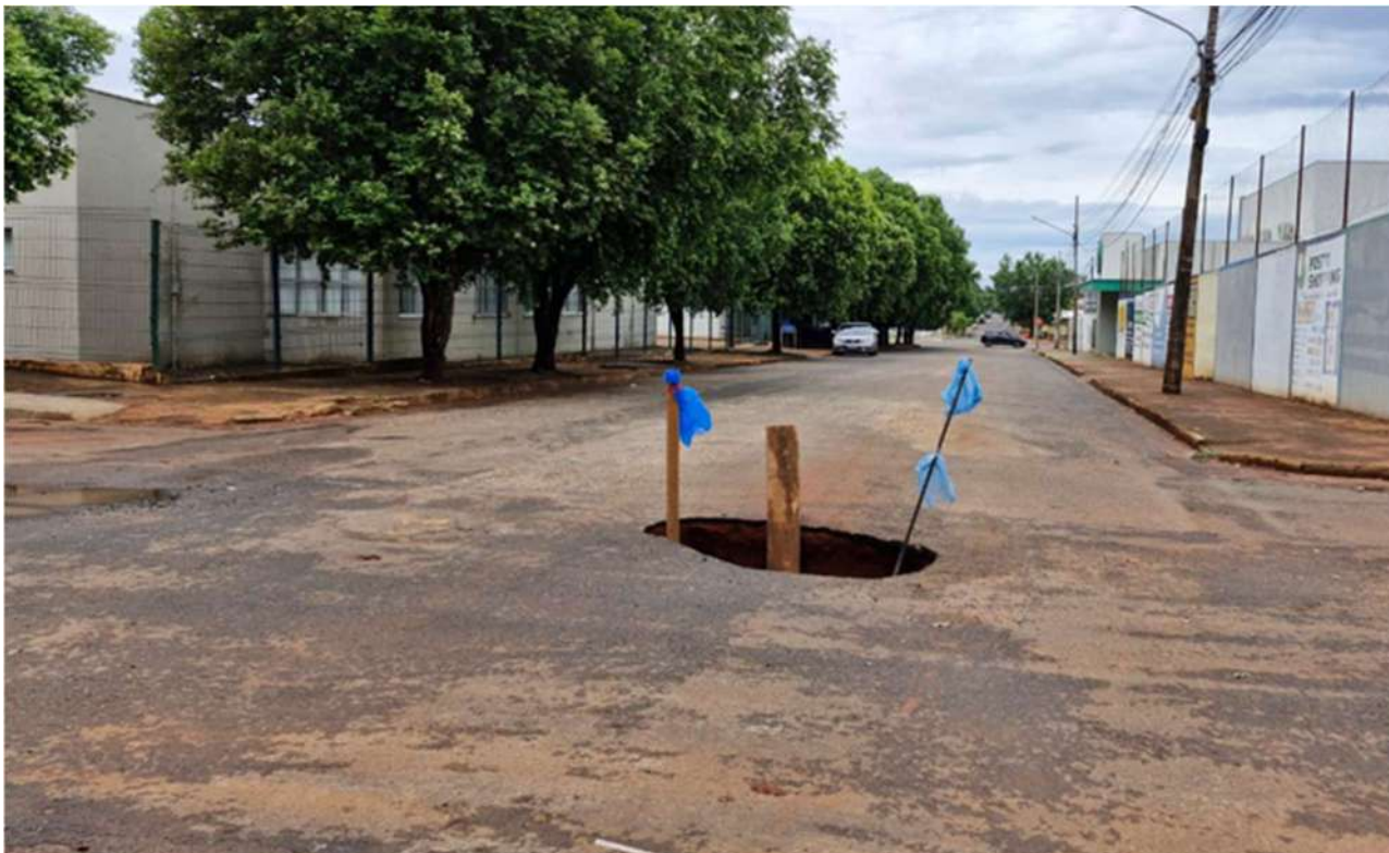
Foto 72: Buraco com risco de acidentes (autor – 2024).
