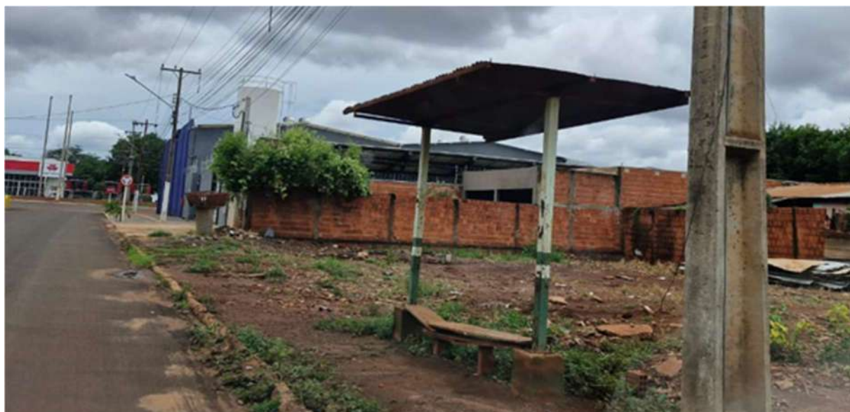
Foto 88: Ausência de padronização dos abrigos (autor – 2024).
