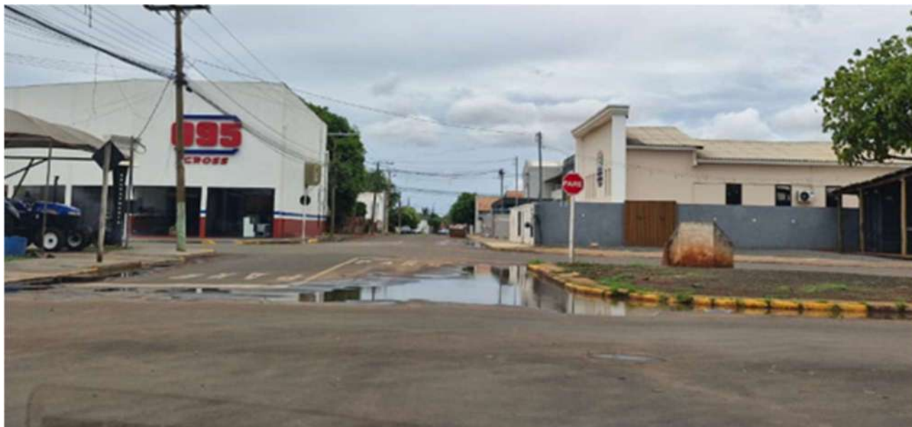
Foto 77: Ausência de escoamento de águas superficiais, risco de queda de motociclistas, situação encontrada em diversos locais da cidade (autor – 2024).
