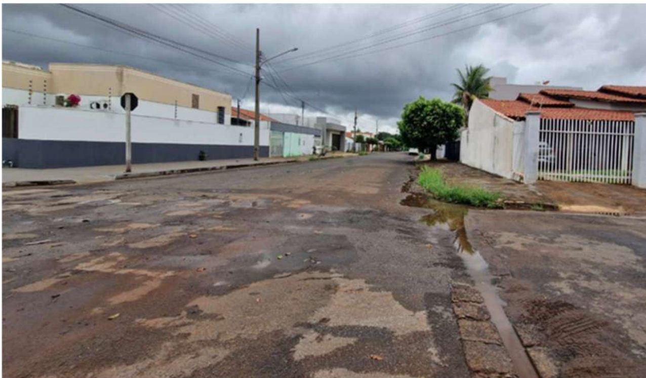
Foto 71: Pavimento com irregularidades de superfície prejudicando a drenagem, situação encontrada em diversas vias da cidade (autor – 2024).
