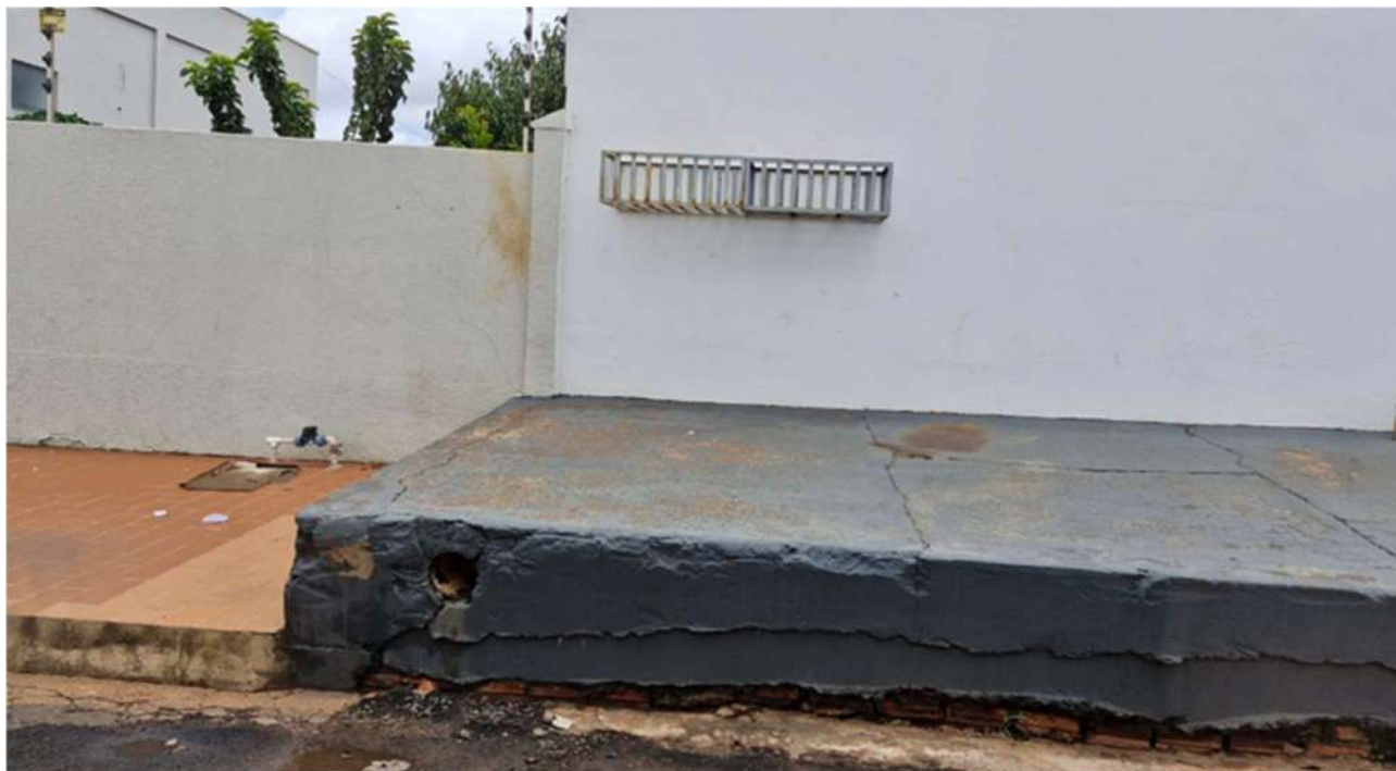
Foto 42: Degrau prejudicando a acessibilidade, situação encontrada em vários pontos da cidade (autor-2024).
