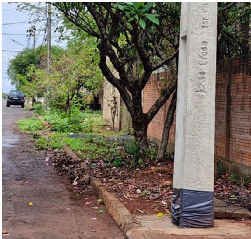
Foto 46: Ausência de pavimento na calçada, situação encontrada em vários pontos da cidade (autor - 2024).
