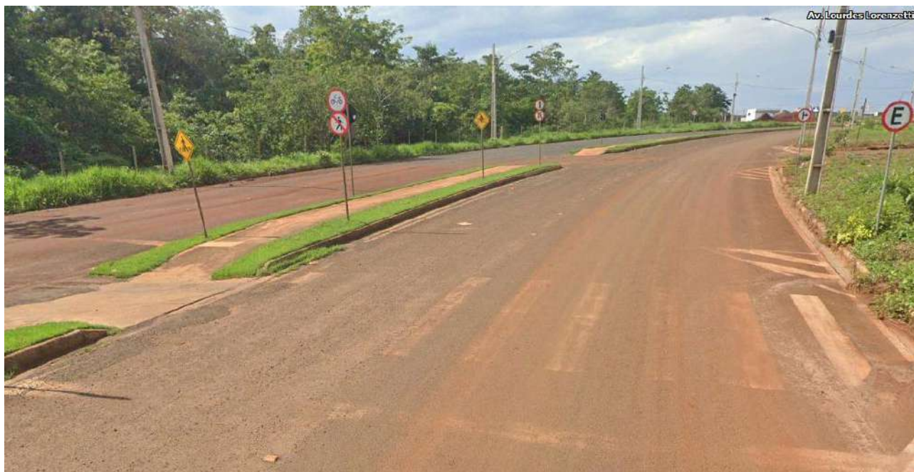
Imagem 64: Ciclovia existente, mas necessária revitalização de pintura e complemento de iluminação.
